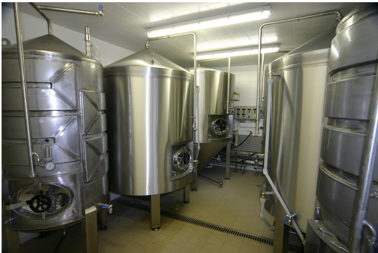
Náhled do ležáckého sklepa – kvasné a ležácké tanky o obsahu 10 a 20 hl
